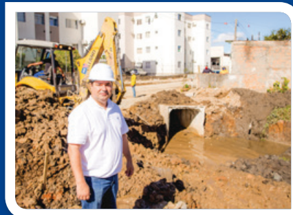
Macro drenagem na região da Rua Célia Ana Feltz, Serraria.
