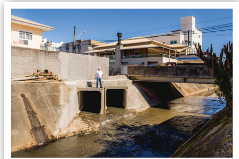
Macro drenagem no Bela Vista, no antigo Rio da Palha, Ipiranga/Areias.
